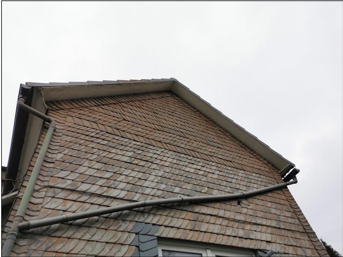
Abbildung 13: Schadhafte Holzverkleidung, Haus Nr. 48
