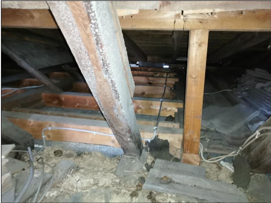
Abbildung 14: Dachstuhl mit nicht einsehbaren Bereichen, Haus Nr. 48
