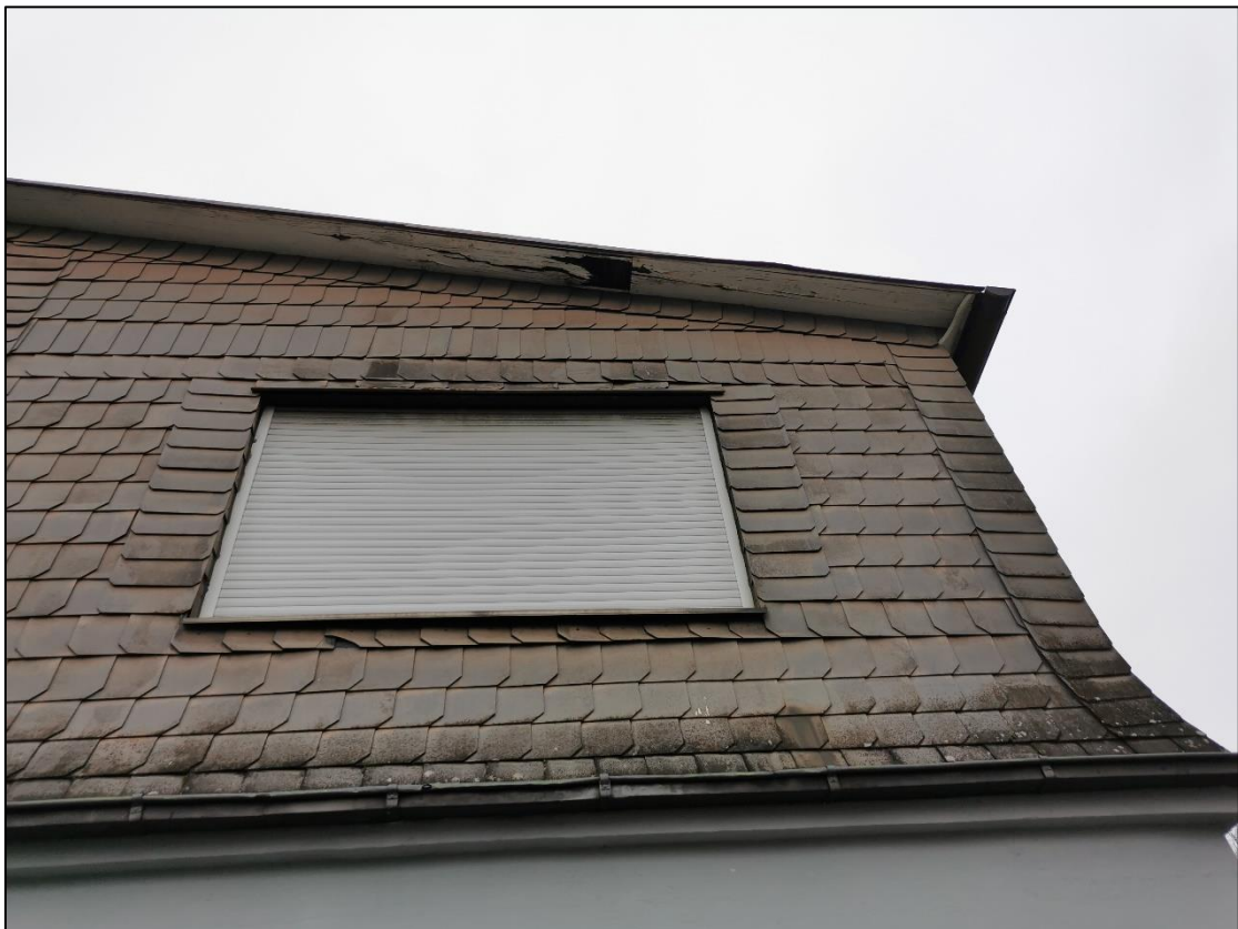
Abbildung 12: Schadhafte Holzverkleidung, Haus Nr. 48
