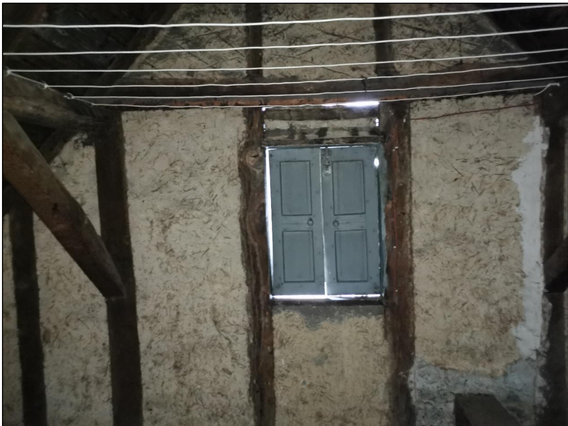
Abbildung 15: Lücken in der Einfassung des Fensters, Haus Nr. 48
